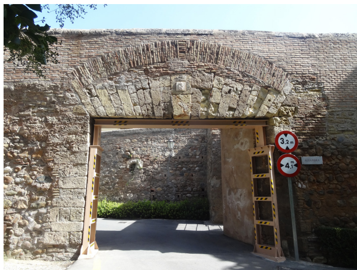
Lámina 27. Puerta de los Carros reforzada con estructuras metálicas en sus jambas y dintel por un accidente en 2018. (C. Vílchez. 2018).
